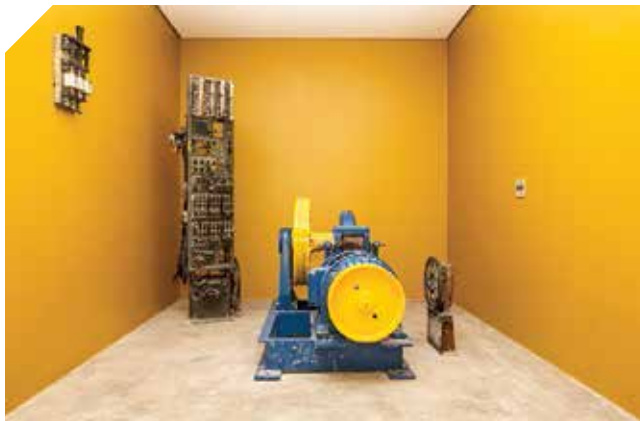
Casa de máquinas sem modernização Machine room without modernization
