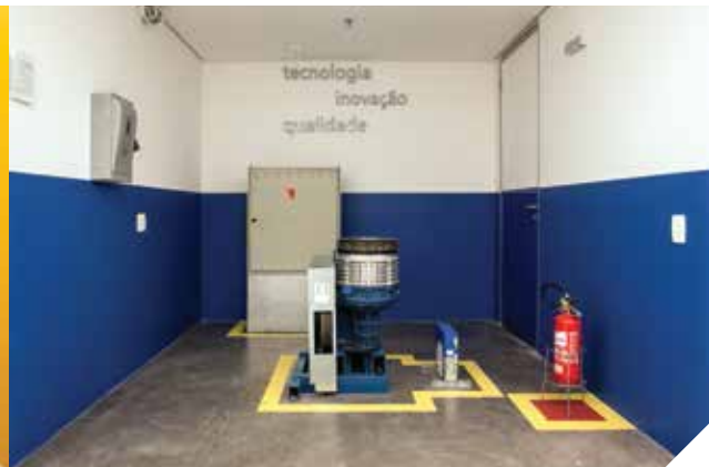
Casa de máquinas modernizada Machine room modernized
