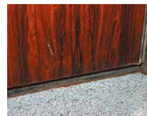
経年とともに傷んだ床と幅木
