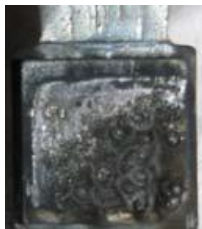
接点が摩耗している状態
