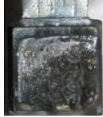
接点が摩耗している状態
