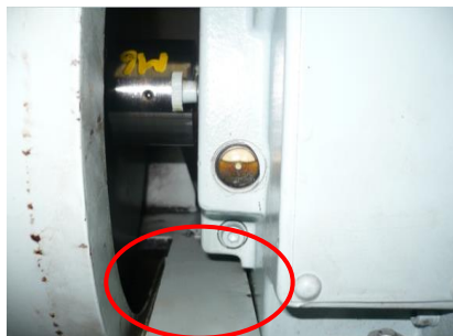
<摩耗粉の無い正常な状態>
