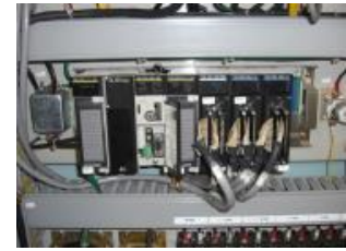
<PLCユニット>
