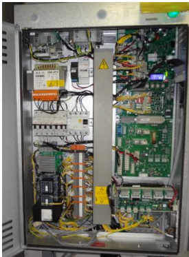
<制御盤全体写真>
