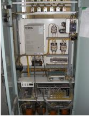
<制御盤全体写真>
