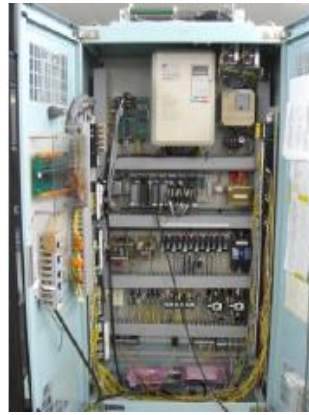
<制御盤全体写真>
