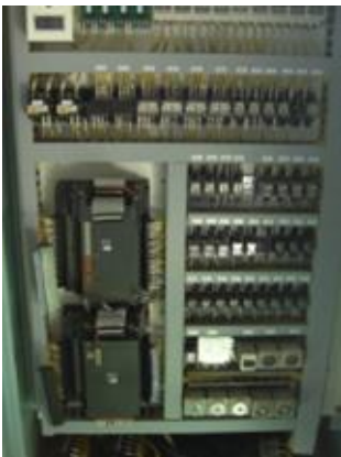
<制御盤全体写真>
