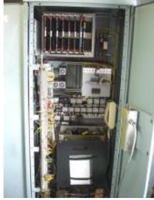
<制御盤全体写真>
