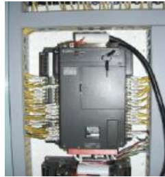
<PLCユニット>
