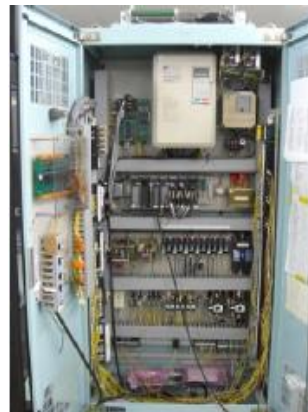
<制御盤全体写真>
