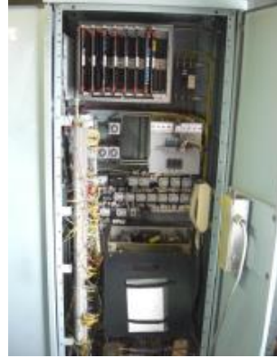
<制御盤全体写真>
