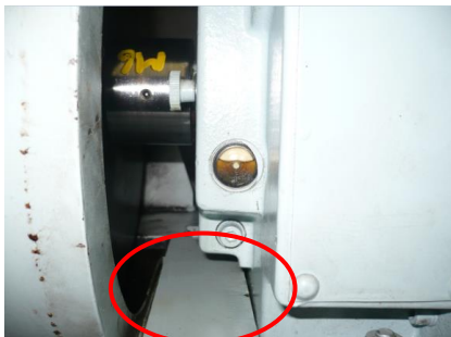
<摩耗粉の無い正常な状態>
