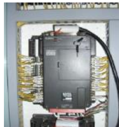
<PLCユニット>
