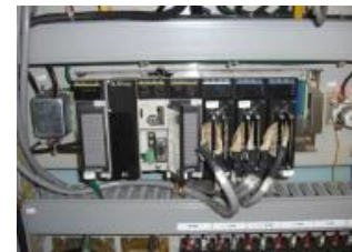
<PLCユニット>
