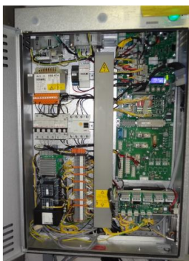
<制御盤全体写真>
