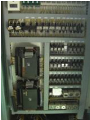
<制御盤全体写真>
