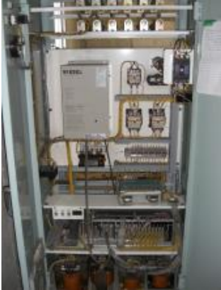
<制御盤全体写真>
