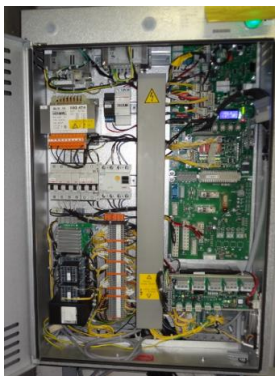
<制御盤全体写真>
