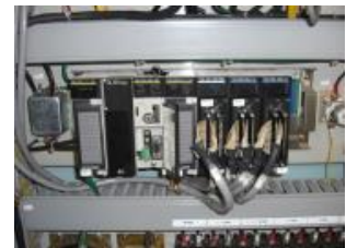
<PLCユニット>
