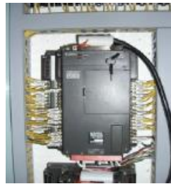
<PLCユニット>
