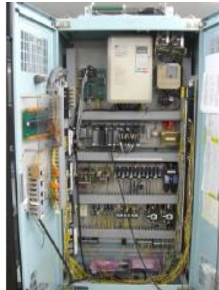
<制御盤全体写真>
