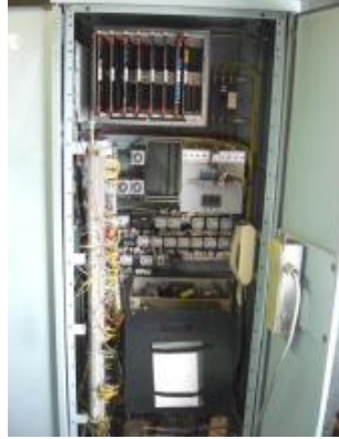
<制御盤全体写真>
