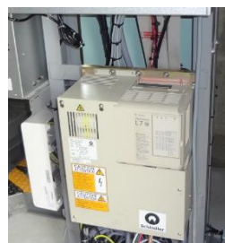
<インバーターユニット>
