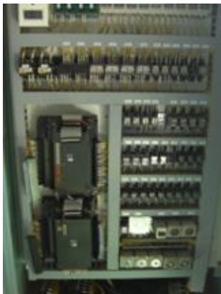
<制御盤全体写真>
