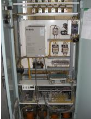
<制御盤全体写真>
