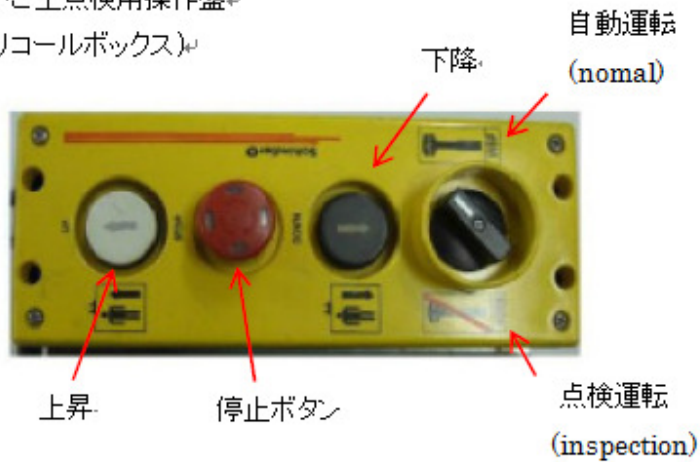
かご上点検用操作盤 (リコールボックス)
