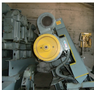
地震被害例 1 (巻上機転倒)
