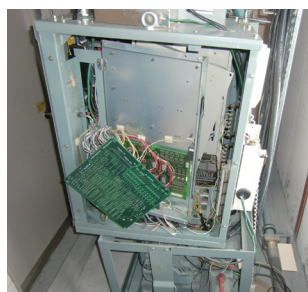
地震被害例 2 (制御盤移動)
