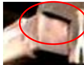
カーボン接点が偏摩耗し段差ができている状態
