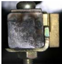
接触不良を起こしている状態
