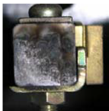
接触不良を起こしている状態
